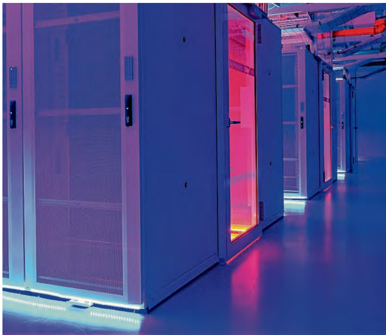
Eine Serverzeile, aufgenommen im SAP Rechenzentrum in Walldorf, das im September 2018 eröffnet wurde. Foto: Uli Deck/dpa
